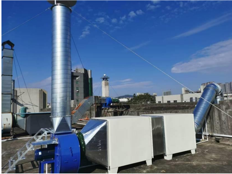
I 栋项目废气处理设施
