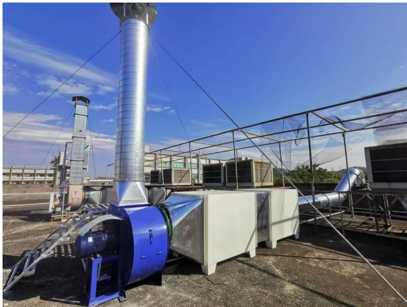
H 栋项目废气处理设施
